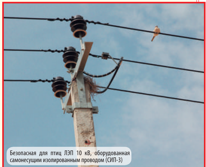
Использование подвесных изоляторов также обеспечивают безопасность птиц, однако лишь в тех случаях, когда расстояние между токонесущими проводами и металлическими траверсами достаточно велико
